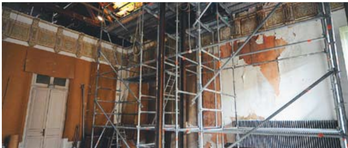
© Estat actual de les pintures a la sala de plens de l'antic Ajuntament. || J. G.
