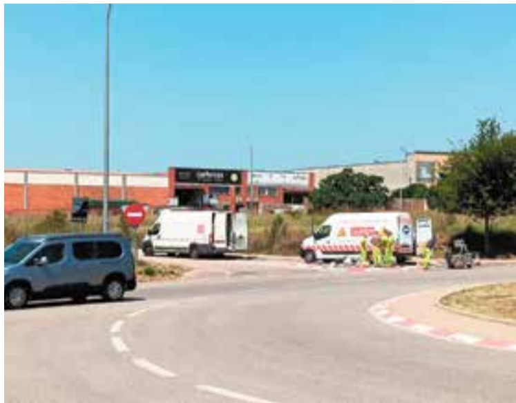
Obres d'adequació del nou accés al polígon de Can Carner. || C. L.
